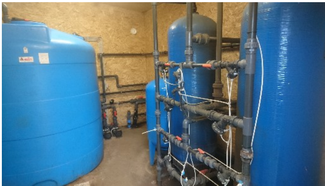
Joonis 15. Saverna puurkaevpumpla sisevaade (2023)
