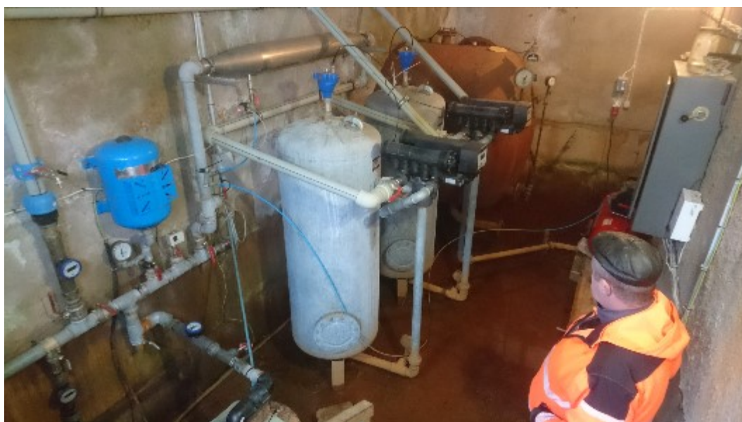
Joonis 19. Krootuse Kaupluse puurkaevpumpla/veetöötlusjaama sisevaade (2023)
