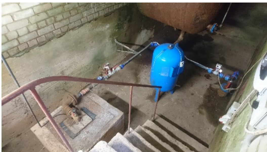
Joonis 32. Soodoma küla puurkaevpumpla hoone sisevaade (2023)
