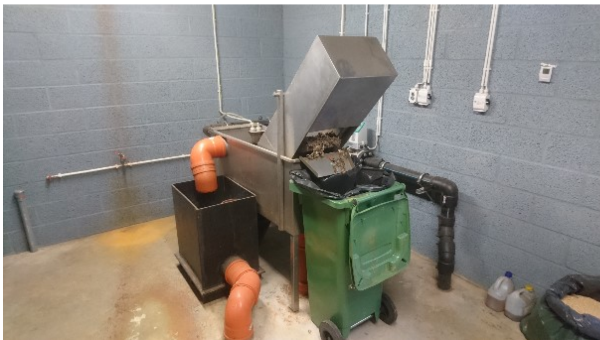
Joonis 29. Maaritsa reoveepuhasti sisevaade (võreseade) (2023)
