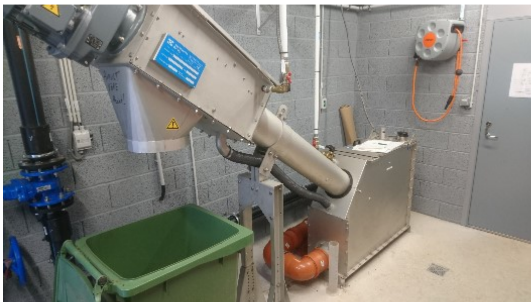
Joonis 24. Valgjärve reoveepuhasti sisevaade (võreseade) (2023)
