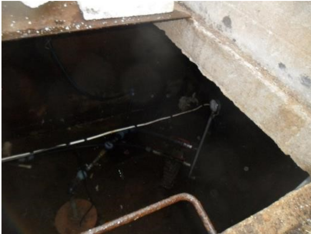
Joonis 48. Kaagvere küla puurkaevpumpla hoone sisevaade (allikas: eelmine ÜVK arendamise kava)
