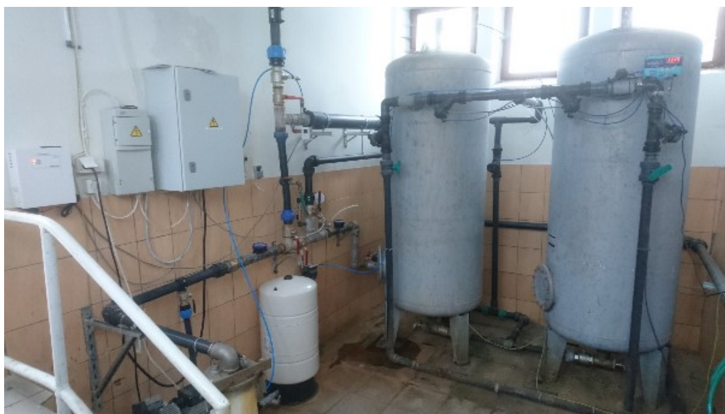
Joonis 3. Kanepi Kooli puurkaevpumpla/veetöötlusjaama sisevaade (2023)
