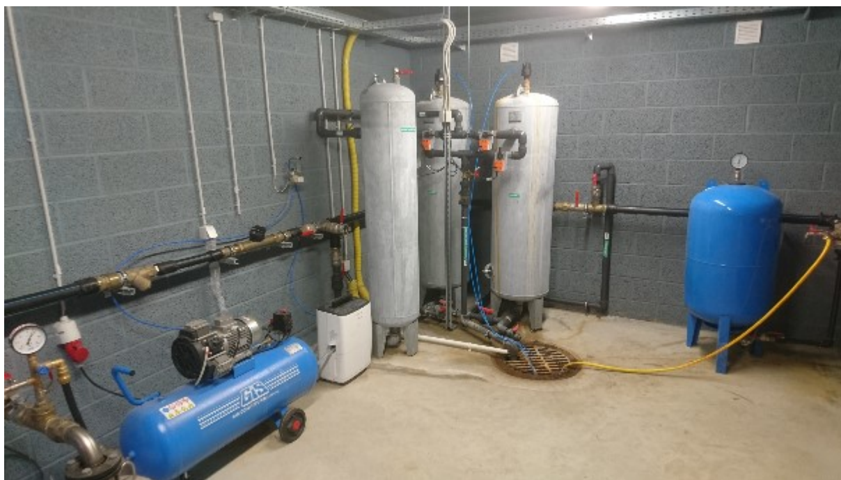
Joonis 27. Maaritsa küla puurkaevpumppla hoone sisevaade (2023)
